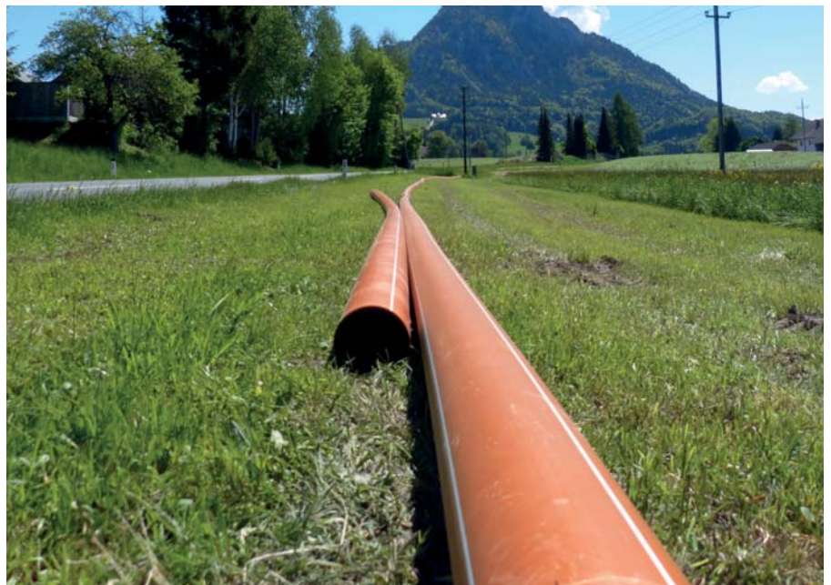
Mehr als drei Kilometer PE Kanal RC ROBUST Rohre kamen für die Erweiterung des Kanalnetzes zum Einsatz.
